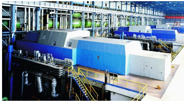
23: Uspořádání turbosoustrojí 4x200 MW ve strojovně elektrárny Dětmarovice
